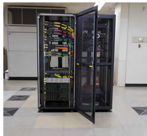
気象衛星データ配信システムの全景
